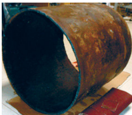
Рис.1. Катушка (фрагмент) аварийного участка конденсатопровода.
